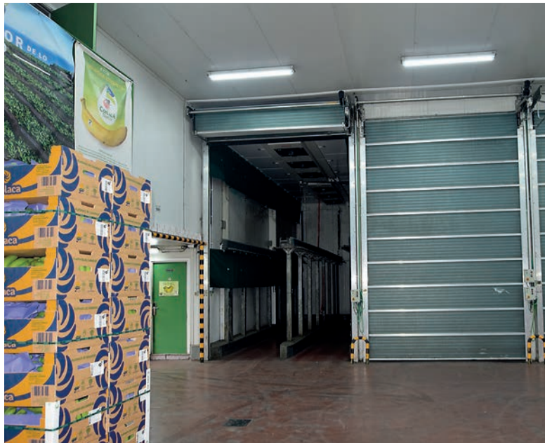
Cámaras de maduración de plátanos y frutas tropicales. / FRÍO VIZCAYA
